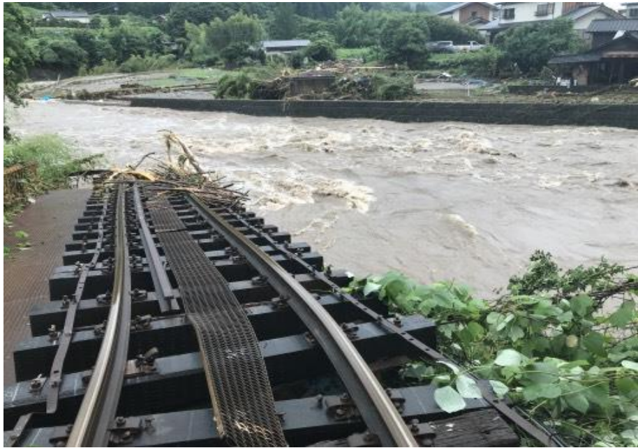
(流出した久大本線の第二野上川橋りょう)
